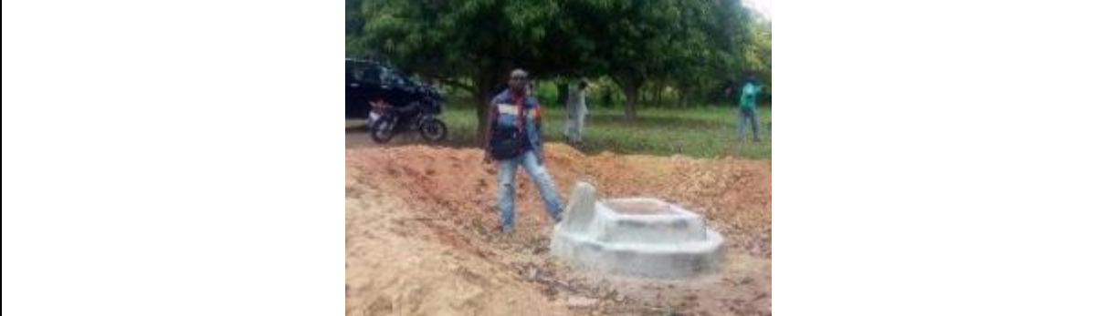
Photo 13 : Puits présent sur le site et appartenant à Monsieur BAH Mamadou Gaoussou Laye, détenteur du TF n°2005
